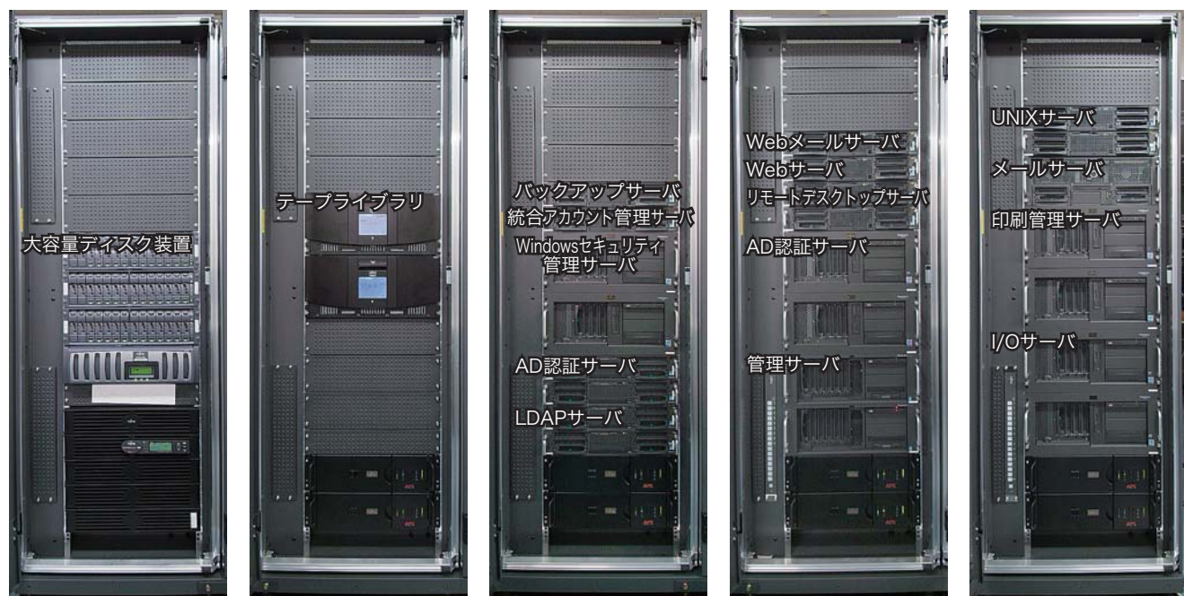
教育用計算機システムサーバ群搭載ラック
