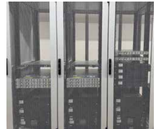
統一認証システム (仮想化基盤上に設置)
